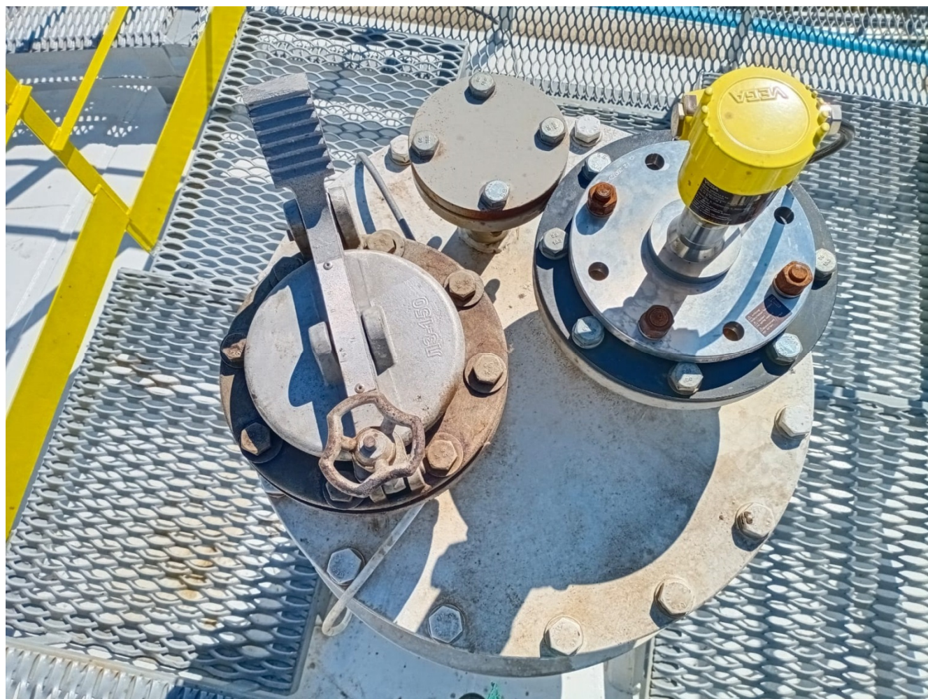
Рисунок 5 – Фотография крышки замерного люка резервуара вертикального стального цилиндрического с понтоном РВСП-10000 заводской номер 50.
