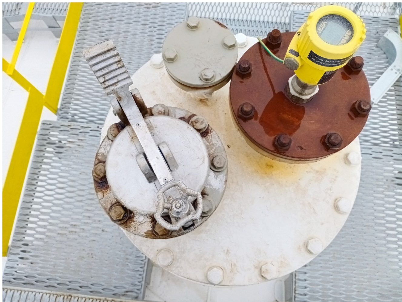
Рисунок 7 – Фотография крышки замерного люка резервуара вертикального стального цилиндрического с понтоном РВСП-10000 заводской номер 52.
