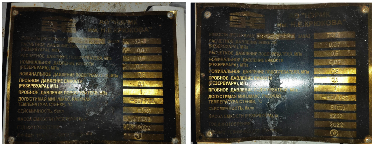
Рисунок 1 – Маркировочные таблички резервуаров
