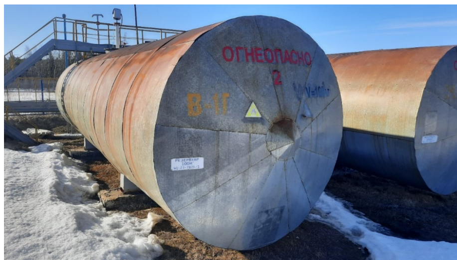
Рисунок 1 – Общий вид резервуаров РГС-100
