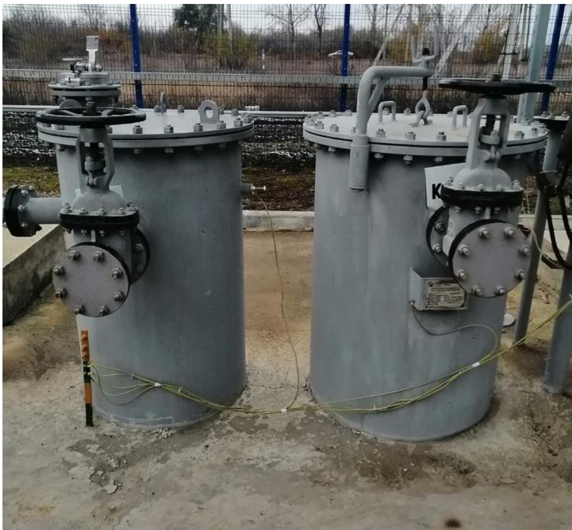
Рисунок 3 – Горловины и измерительный люк резервуара
