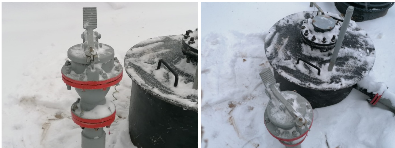
Рисунок 2 – Общий вид горловины и замерного люка резервуара стального горизонтального цилиндрического РГС-10
