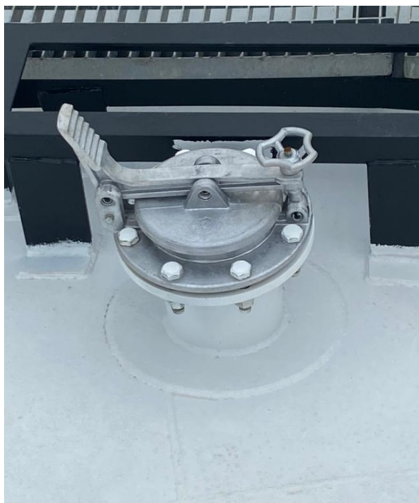
Рисунок 5 – Фото замерного люка резервуаров PBC-2000
