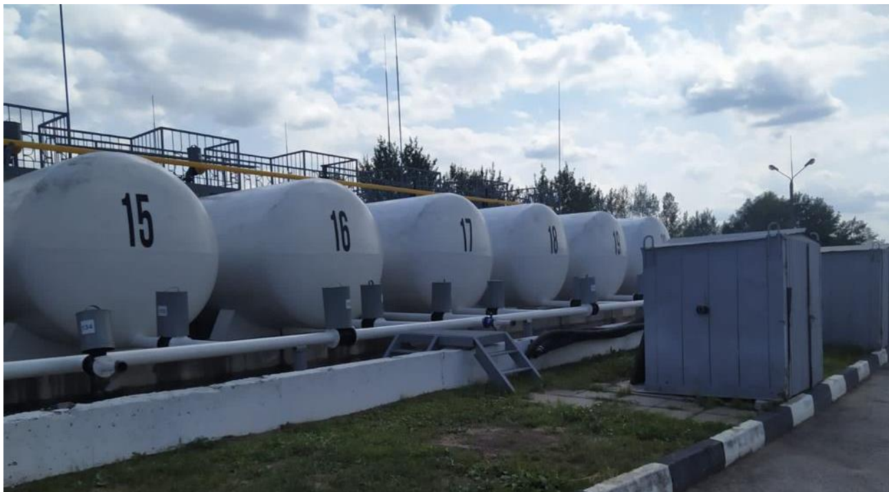
Рисунок 1 – Общий вид резервуаров РГС-50
