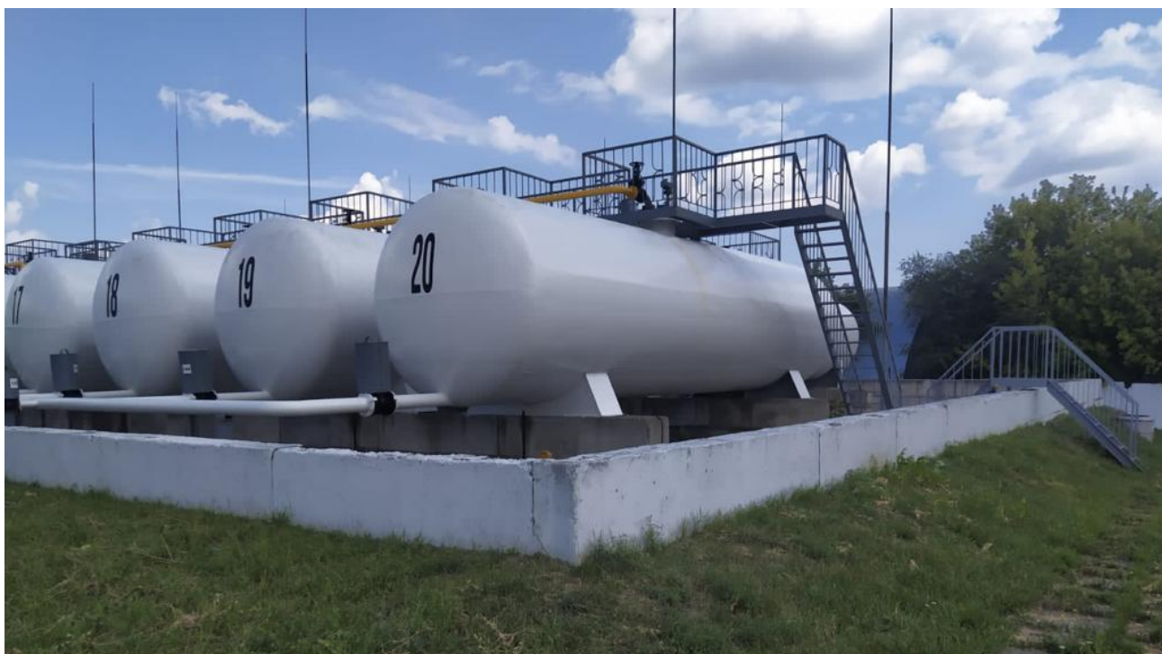
Рисунок 2 – Общий вид резервуаров РГС-50
