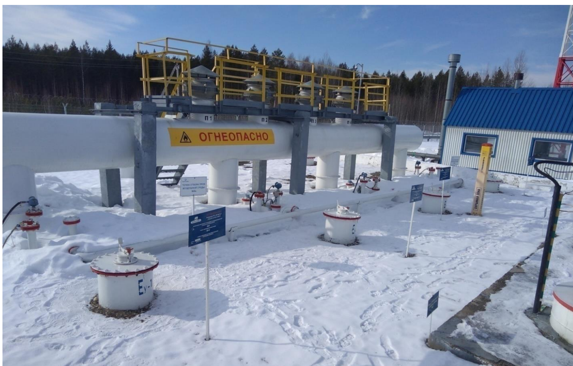
Рисунок 1– Общий вид площадки размещения резервуаров горизонтальных стальных цилиндрических РГС-100
