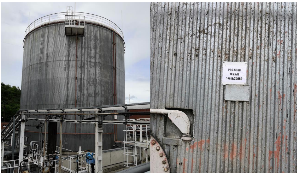
Рисунок 3 - Общий вид резервуара стального вертикального цилиндрического теплоизолированного PBC-5000, заводской № 25060
