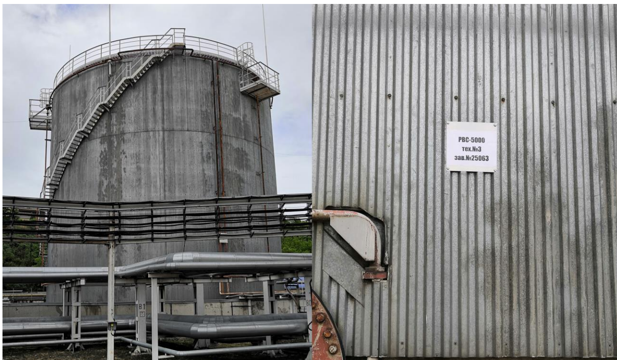
Рисунок 6 - Общий вид резервуара стального вертикального цилиндрического теплоизолированного PBC-5000, заводской № 25063
