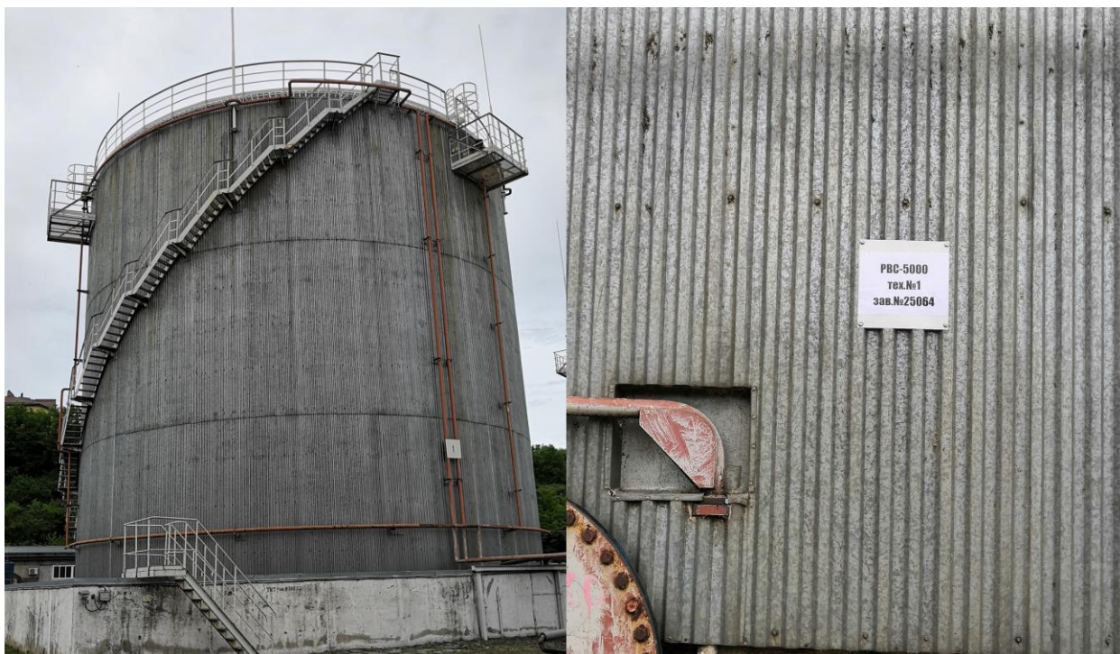
Рисунок 7 - Общий вид резервуара стального вертикального цилиндрического теплоизолированного PBC-5000, заводской № 25064
