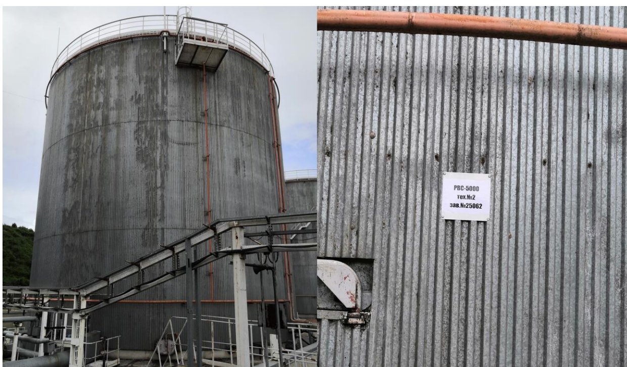
Рисунок 5 - Общий вид резервуара стального вертикального цилиндрического теплоизолированного PBC-5000, заводской № 25062
