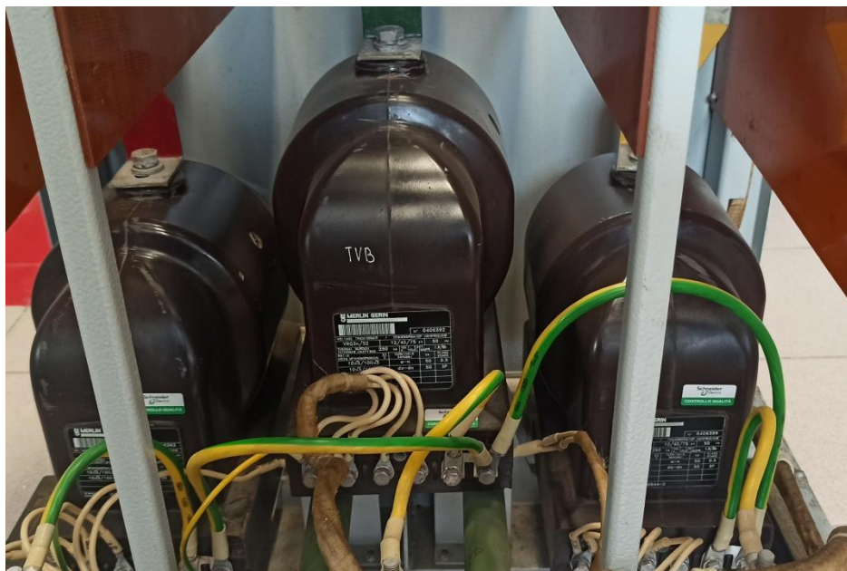
Рисунок 1 – Общий вид трансформаторов напряжения
