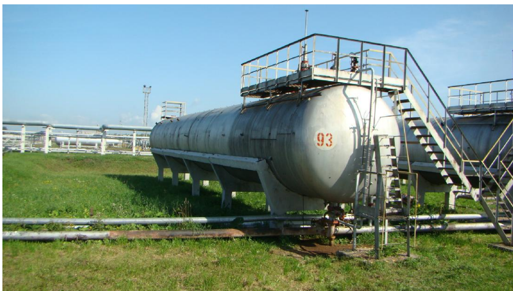
Рисунок 1 - Общий вид резервуаров стальных горизонтальных цилиндрических РГС-175
