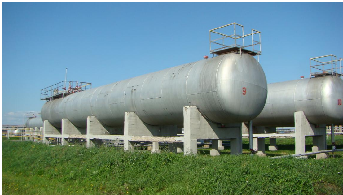
Рисунок 1 - Общий вид резервуаров стальных горизонтальных цилиндрических РГС-175
