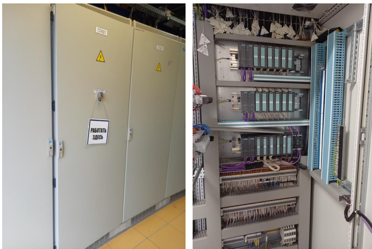
Рисунок 1 – Внешний вид контроллерного шкафа
