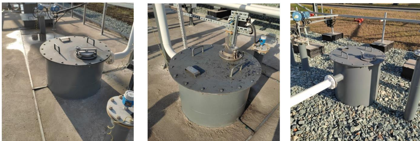
Рисунок 2 – Общий вид резервуаров ЕП-63
