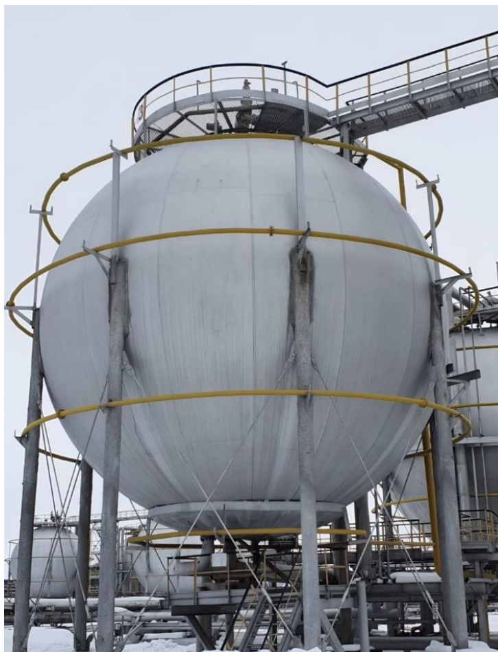
Рисунок 1 – Общий вид резервуаров РИС-600
