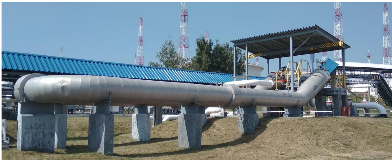
Рисунок 1 – Общий вид установки поверочной трубопоршневой двунаправленной
