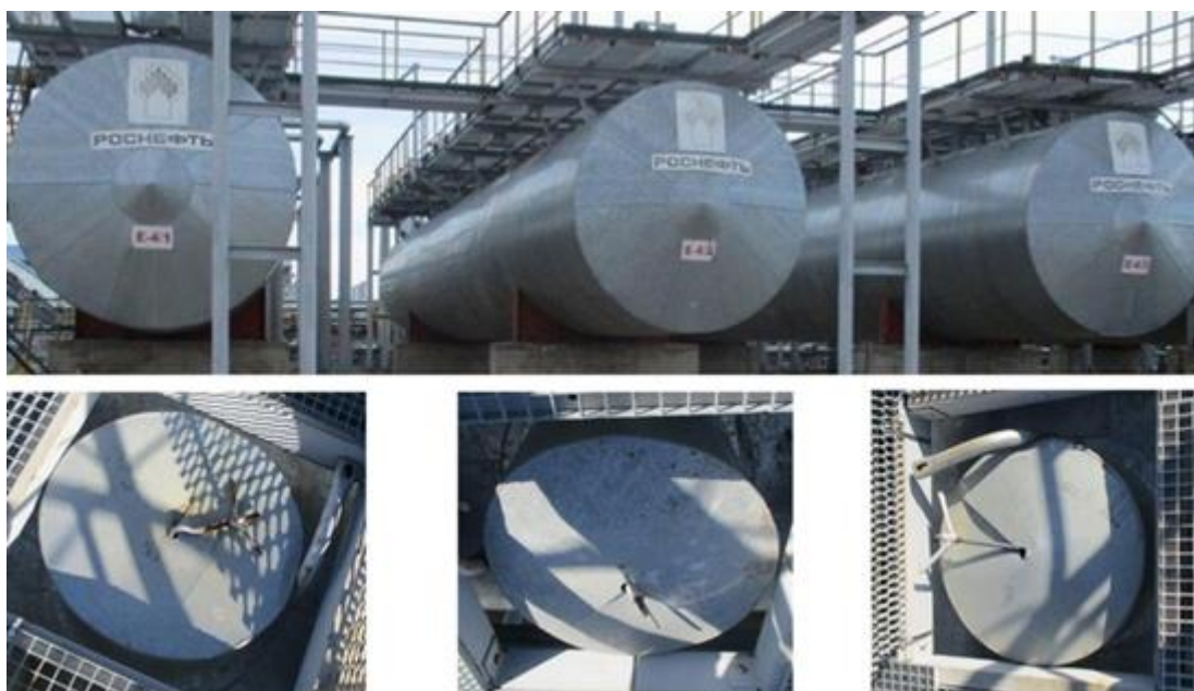
Рисунок 15 – Общий вид резервуаров стальных горизонтальных цилиндрических РГС-200 с заводскими номерами Е-4/1, Е-4/2, Е-4/3
