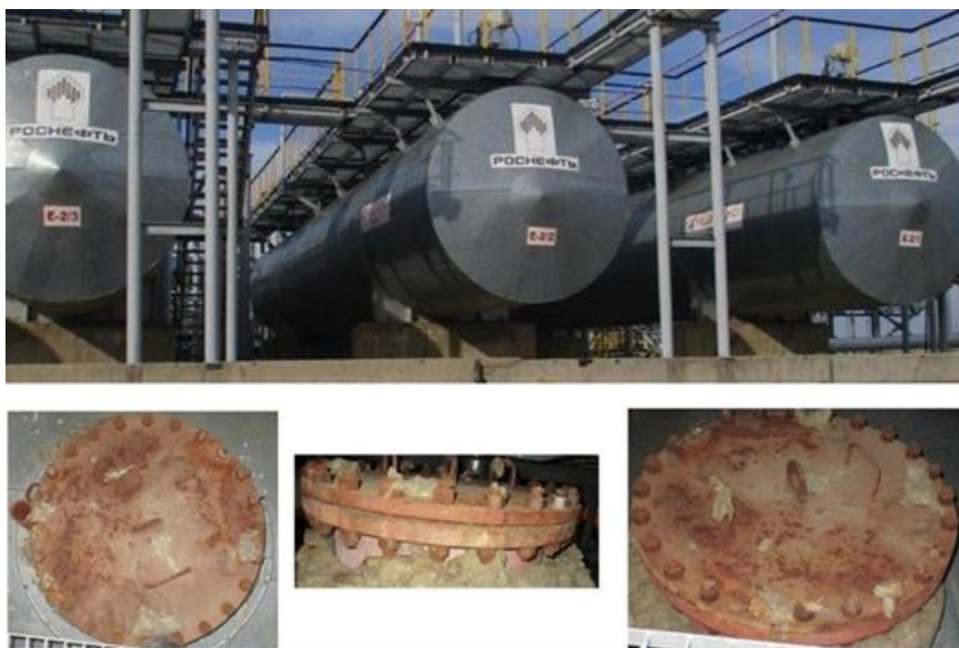
Рисунок 6 – Общий вид резервуаров стальных горизонтальных цилиндрических РГС-200 с заводскими номерами Е-2/1, Е-2/2, Е-2/3
