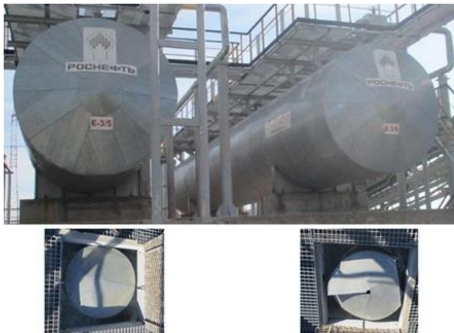
Рисунок 14 – Общий вид резервуаров стальных горизонтальных цилиндрических РГС-200 с заводскими номерами Е-3/5, Е-3/6
