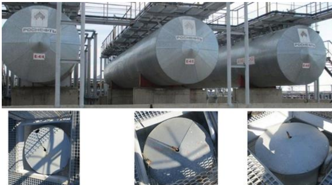
Рисунок 16 – Общий вид резервуаров стальных горизонтальных цилиндрических РГС-200 с заводскими номерами Е-4/4, Е-4/5, Е-4/6
