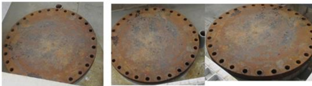
Рисунок 9 – Общий вид резервуаров стальных горизонтальных цилиндрических РГС-200 с заводскими номерами Е-2/10, Е-2/11, Е-2/12
