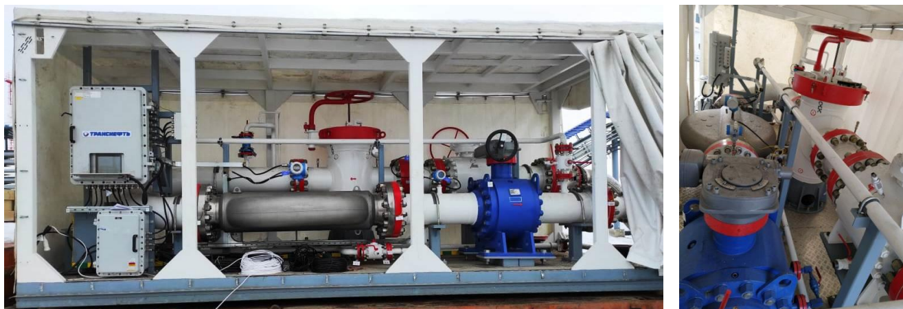
Рисунок 1 – Общий вид установки
