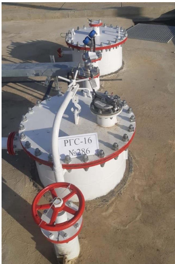
Рисунок 1 – Общий вид резервуаров РГС-16
