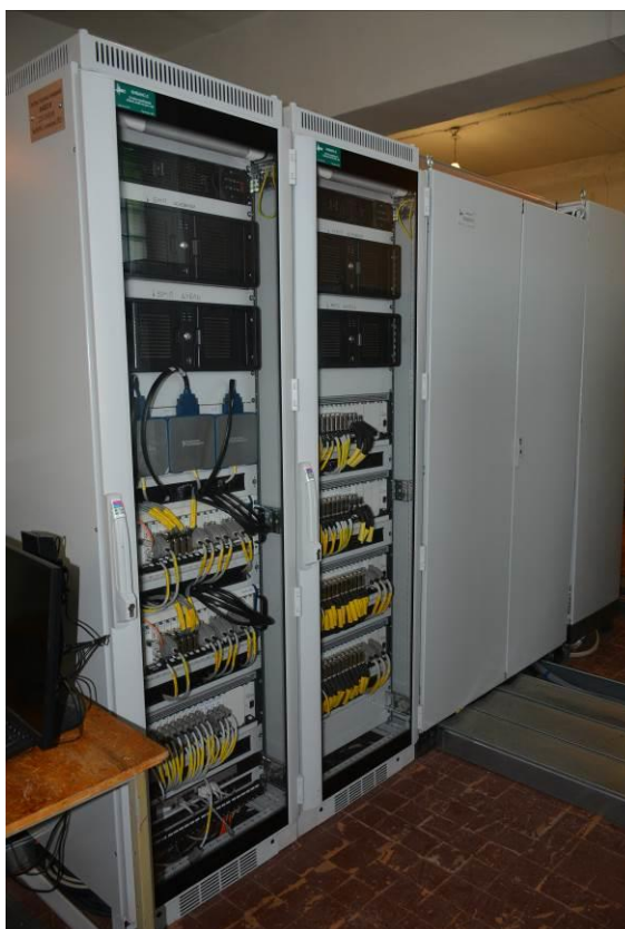
Рисунок 1 – Стойки приборные №1, №2. Шкафы коммутационный и кроссировочный. Вид общий
