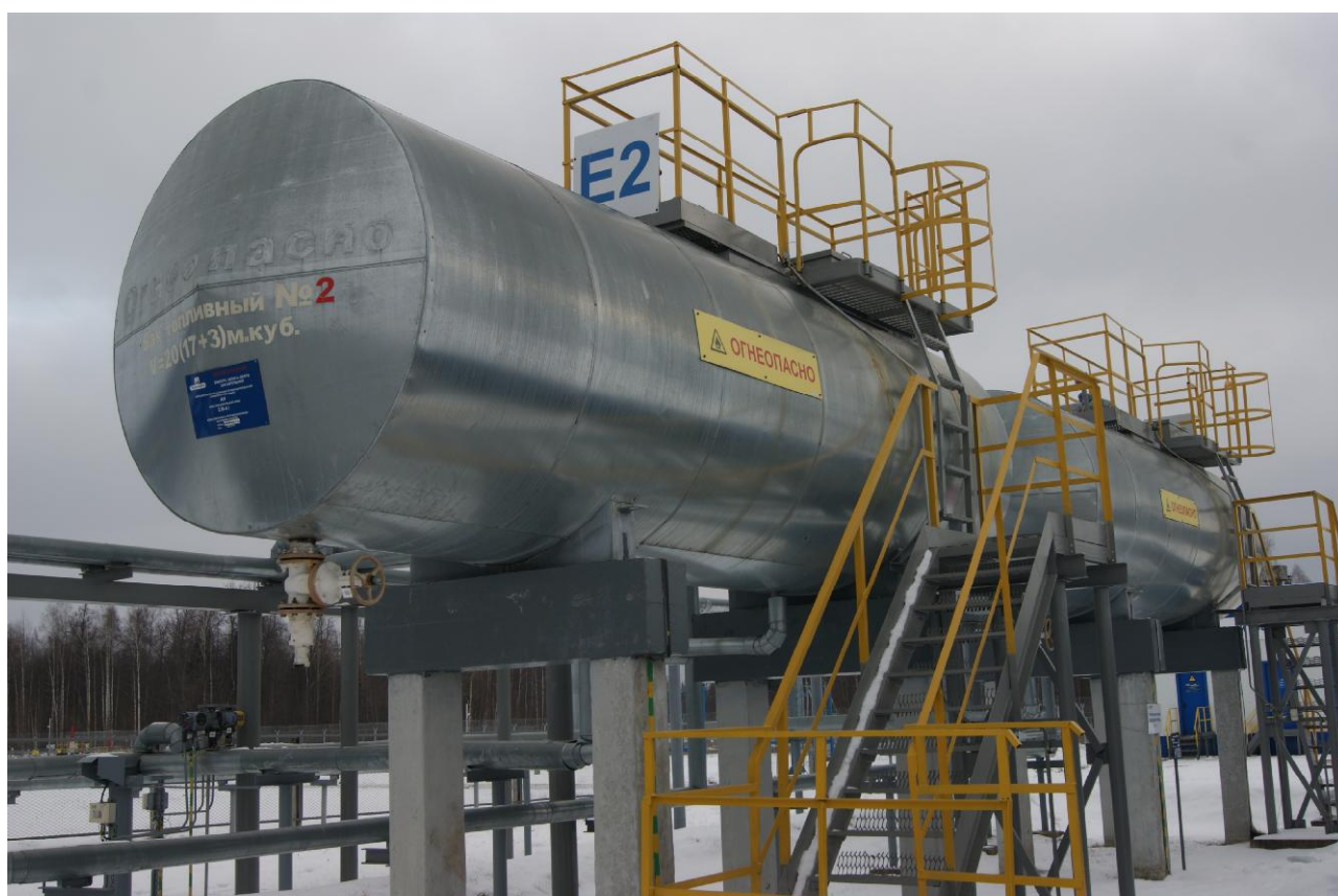
Рисунок 3 - Общий вид резервуаров стальных горизонтальных цилиндрических РГС-20
