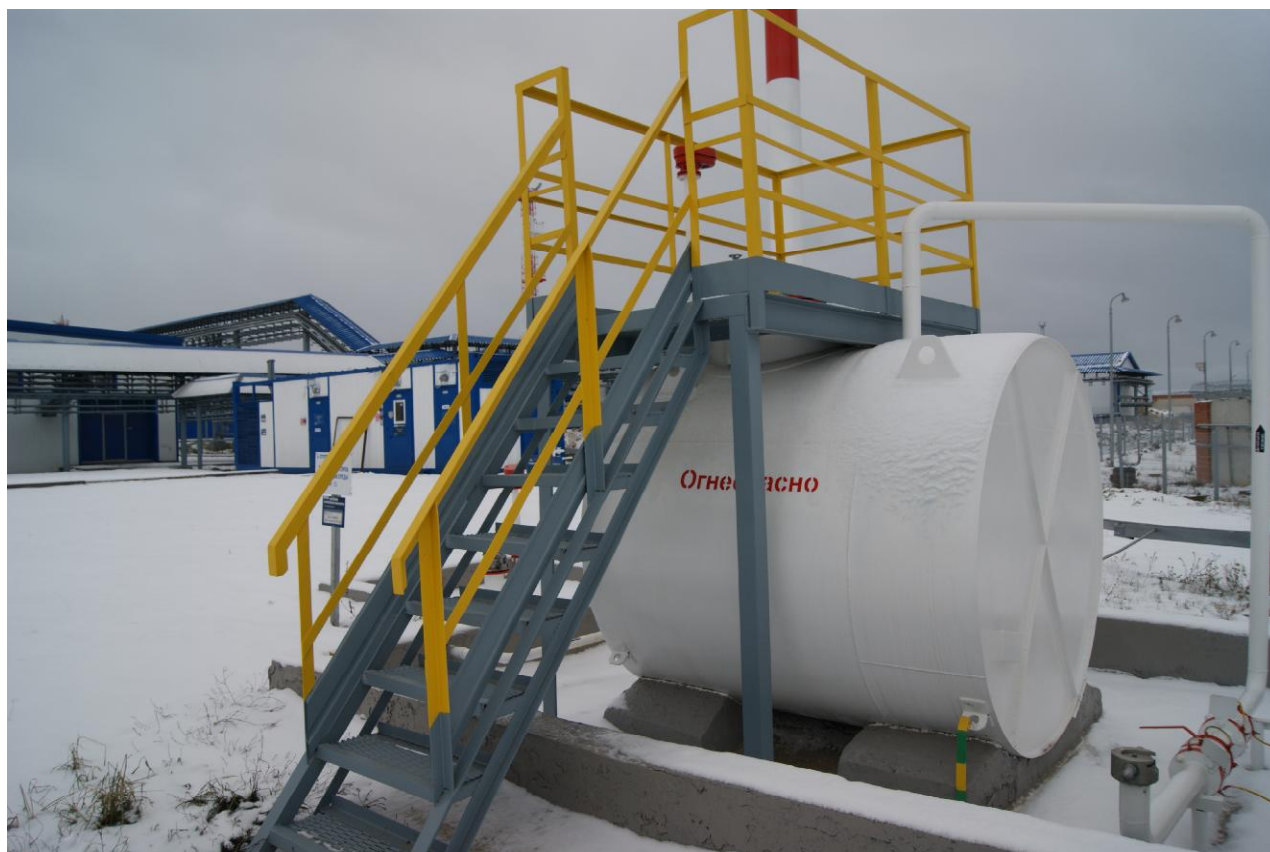
Рисунок 1 - Общий вид резервуаров стальных горизонтальных цилиндрических РГС-5
