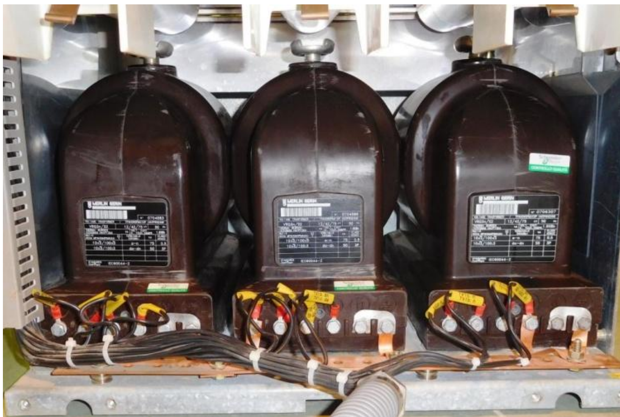
Рисунок 1 – Общий вид трансформаторов напряжения
