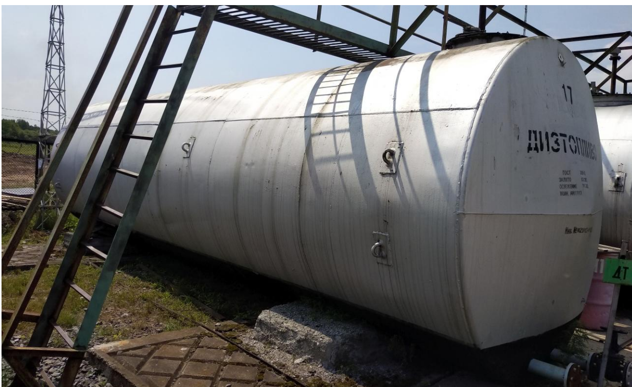
Рисунок 3 – Общий вид резервуаров стальных горизонтальных цилиндрических РГС-75
