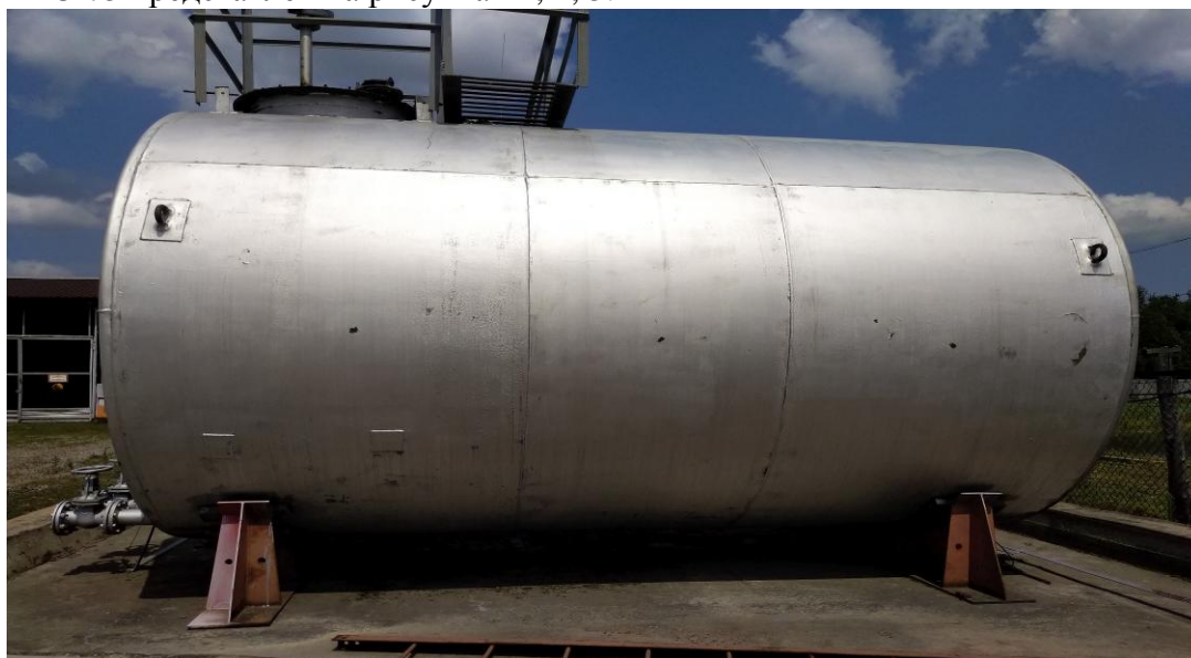
Рисунок 1 – Общий вид резервуаров стальных горизонтальных цилиндрических РГС-25
