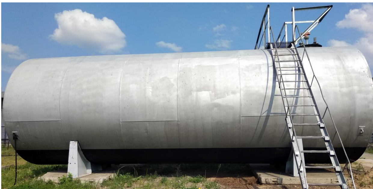
Рисунок 2 – Общий вид резервуаров стальных горизонтальных цилиндрических РГС-50
