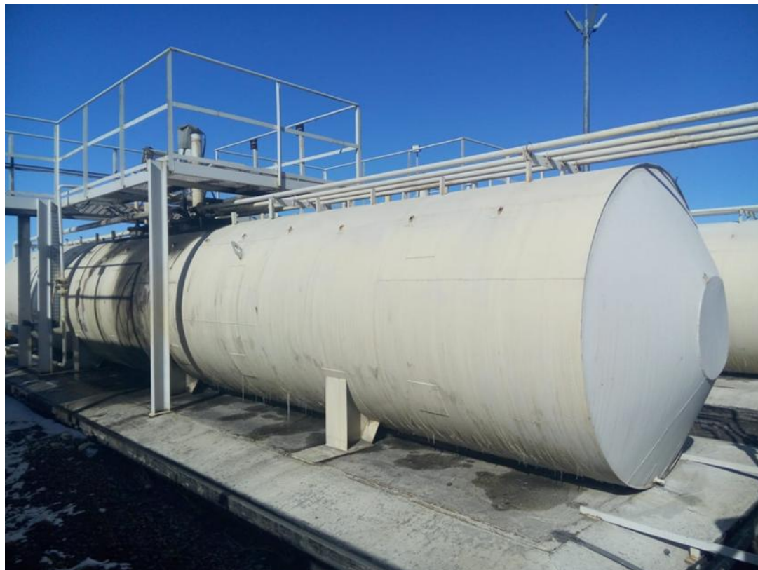
Рисунок 1 – Общий вид резервуаров РГСД-40
