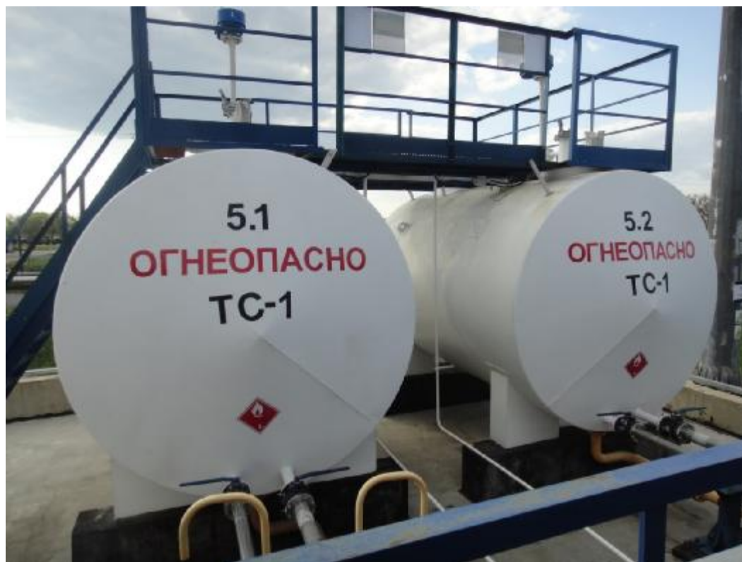
Рисунок 1 – Общий вид резервуаров горизонтальных стальных цилиндрических РГС-25
