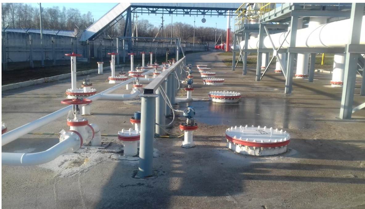
Рисунок 6 – Общий вид площадки размещения резервуаров стальных горизонтальных цилиндрических РГС-100
