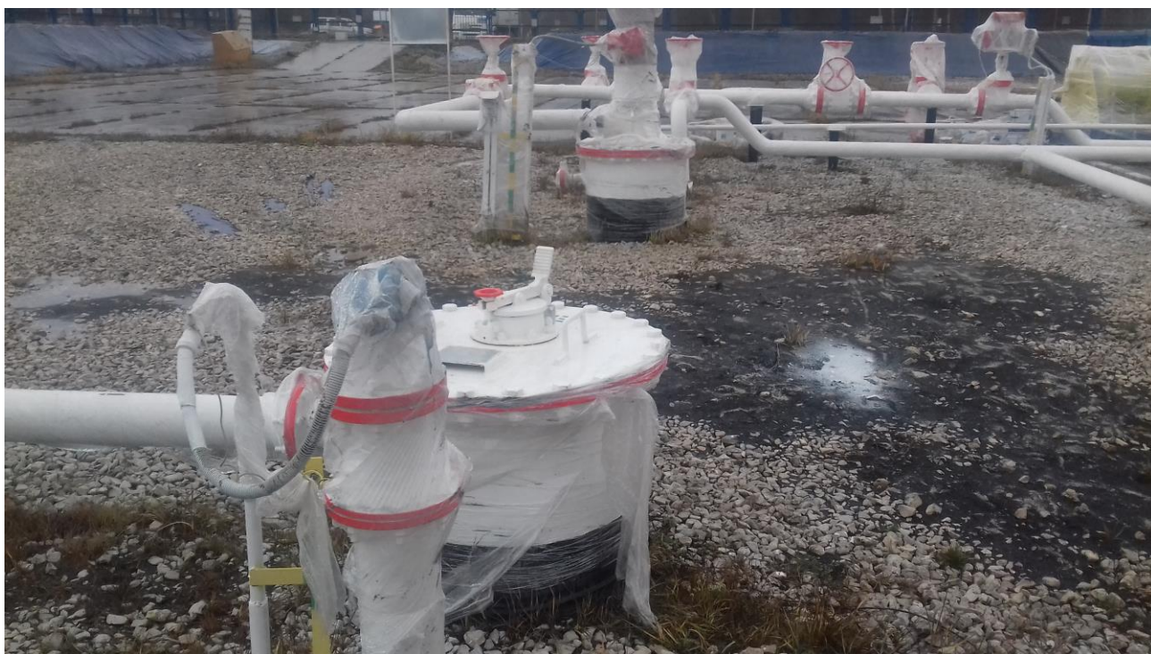
Рисунок 4 – Общий вид площадки размещения резервуаров стальных горизонтальных цилиндрических РГС-40
