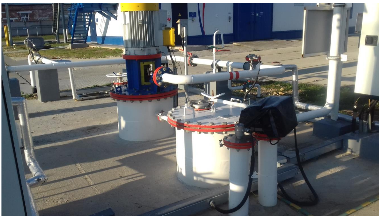
Рисунок 2 – Общий вид площадки размещения резервуаров стальных горизонтальных цилиндрических РГС-20
