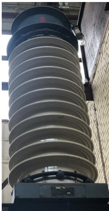
Рисунок 1 – Общий вид трансформаторов
