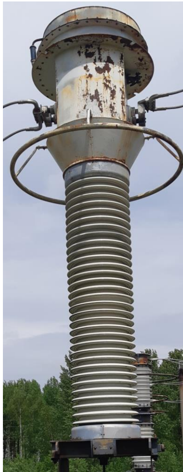
Рисунок 1 - Общий вид трансформаторов
