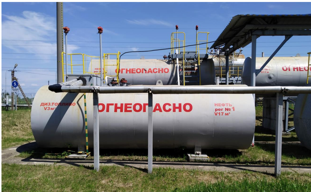
Рисунок 1 – Общий вид резервуаров РГС-20
