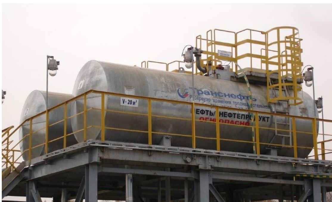
Рисунок 5 – Общий вид резервуаров РГС-20 НПС «Инякино»
