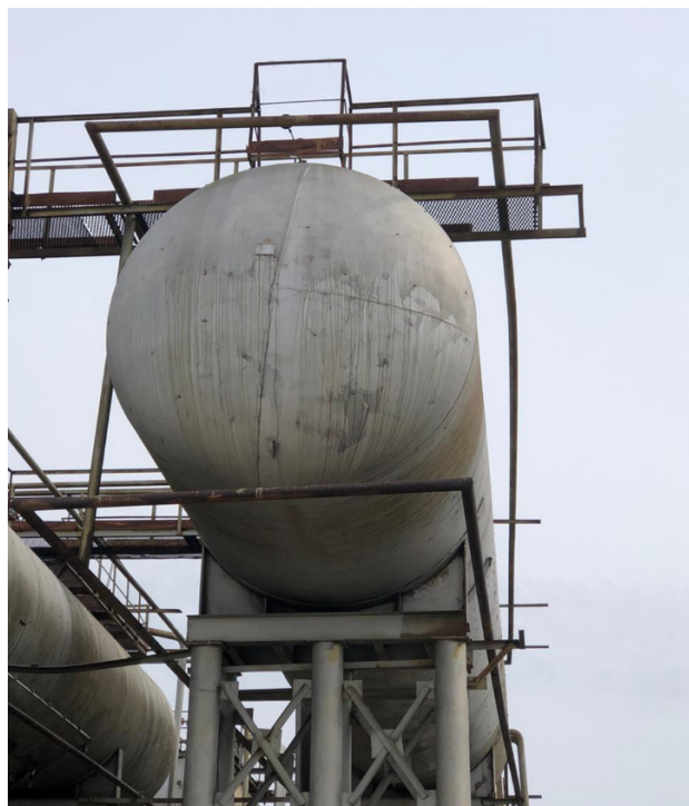
Рисунок 1 – Общий вид резервуаров РГС-200
