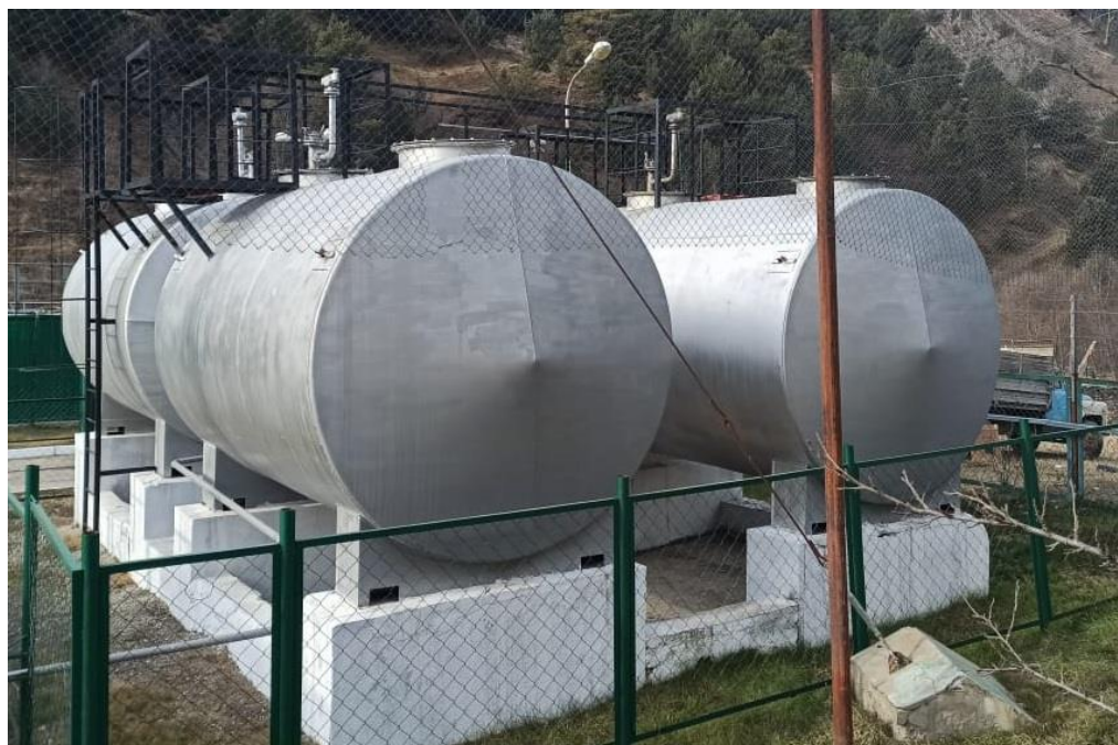
Рисунок 1 – Общий вид резервуаров РГС-25
