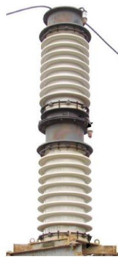
Рисунок 2 – Общий вид трансформаторов напряжения НКФ-220-58 У1
