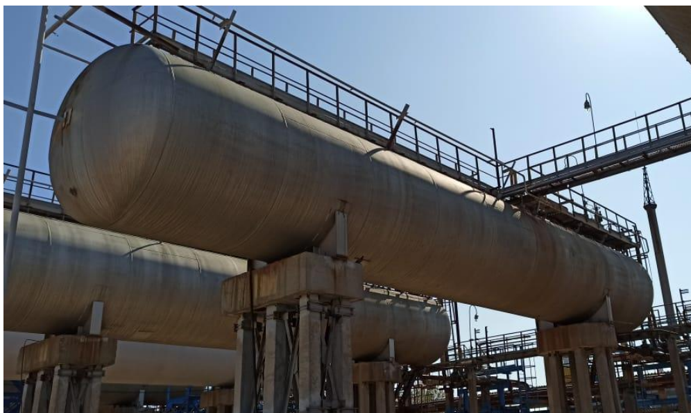
Рисунок 1 – Общий вид резервуаров РГС-200 зав.№№ 8073, 8189, 8277, 8259, 8266, 8316, 8317, 8346, 8349, 8385, 8386
