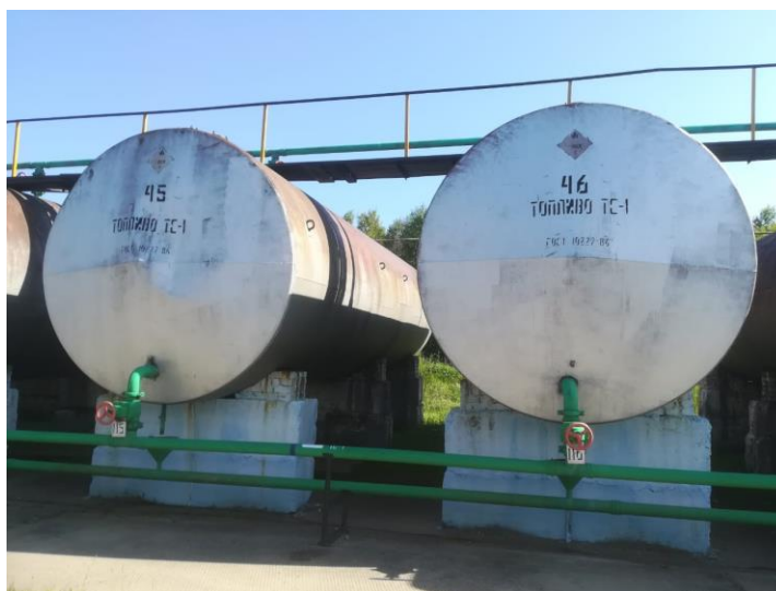
Рисунок 1 – Общий вид резервуаров стальных горизонтальных цилиндрических РГС-50
