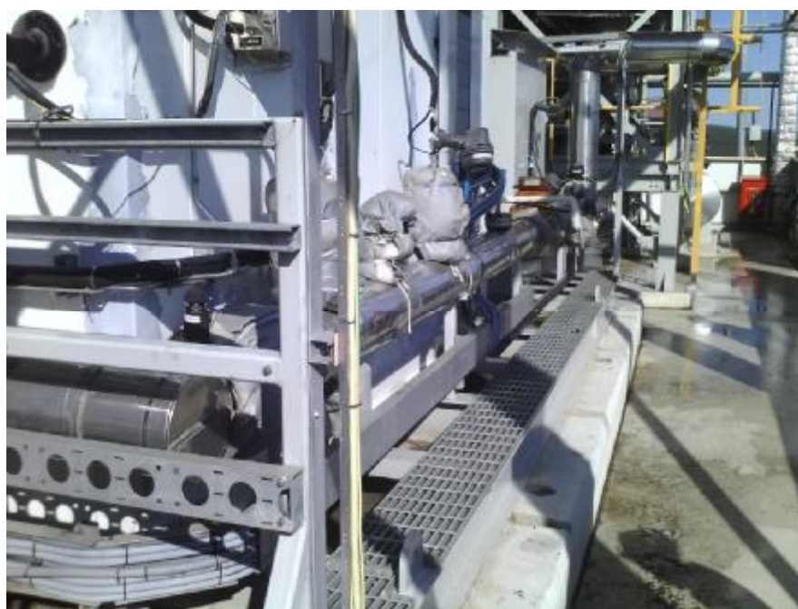
Рисунок 2. Внешний вид измерительного трубопровода
