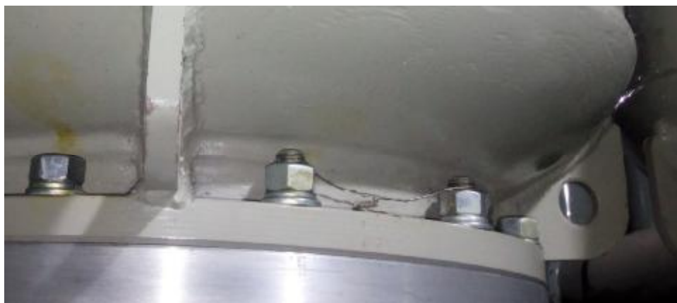
Рисунок 2 – Место пломбировки трансформатора напряжения ЗНОГ-110 – IV УХЛ 4
