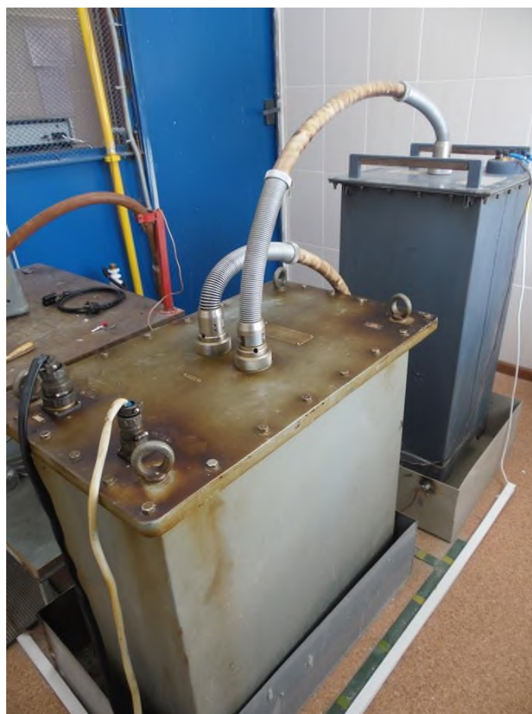
Рисунок 2 - Общий вид высоковольтного блока ИВН-100 и делителя ДНВ-100
