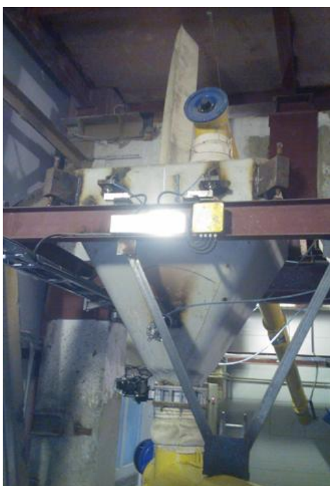
Узел взвешивания цемента
