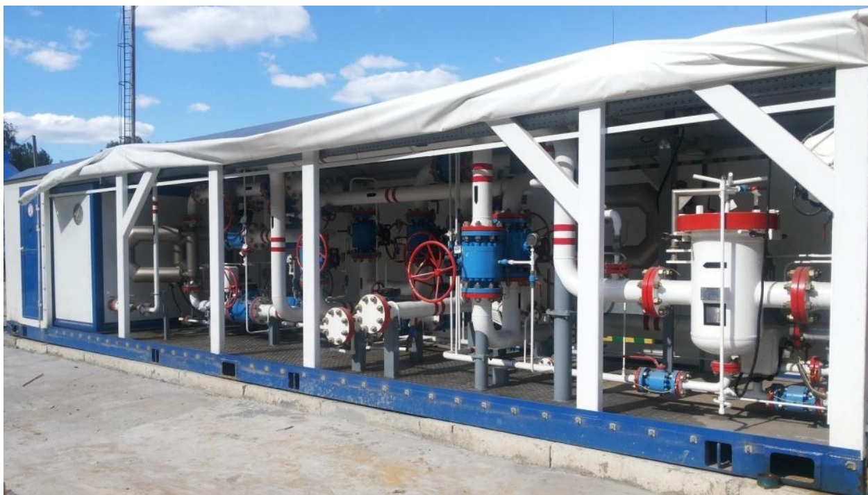
Рисунок 1 – Общий вид СИКН
