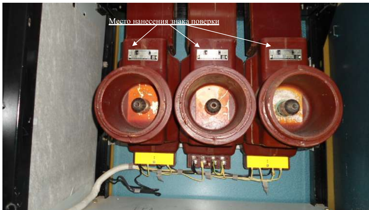
Рисунок 1 - Внешний вид трансформаторов
