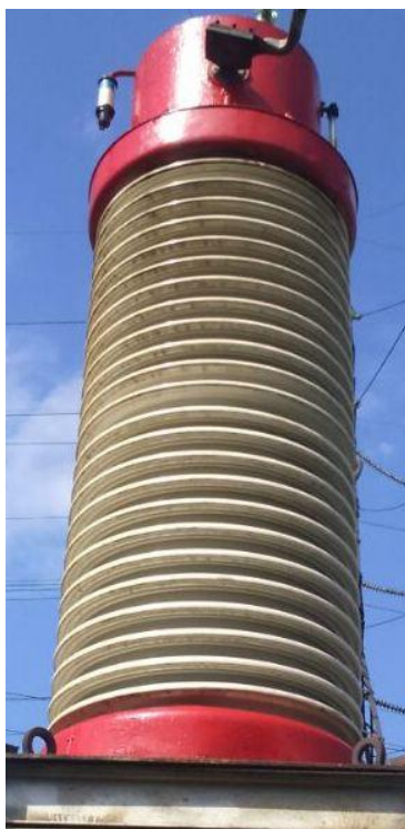
Рисунок 1 – Общий вид трансформаторов тока ТФНД-220-IV
