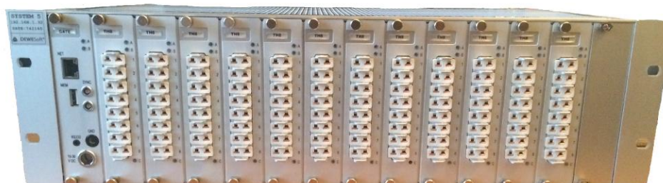
Рисунок 4 - Общий вид модулей DS-NET, установленных в шасси DS-NET RACK
