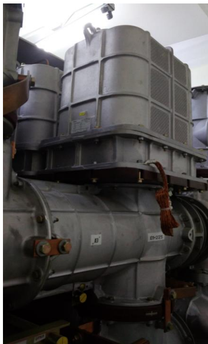
Рисунок 1 - Общий вид трансформаторов
