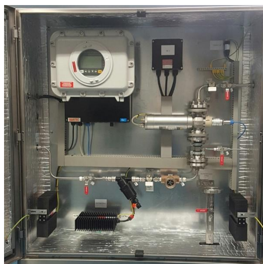
Рисунок 4 - Общий вид анализатора во взрывозащитном исполнении в шкафу, включая: преобразователь, датчик, электрическую систему обогрева и пробоподготовки
