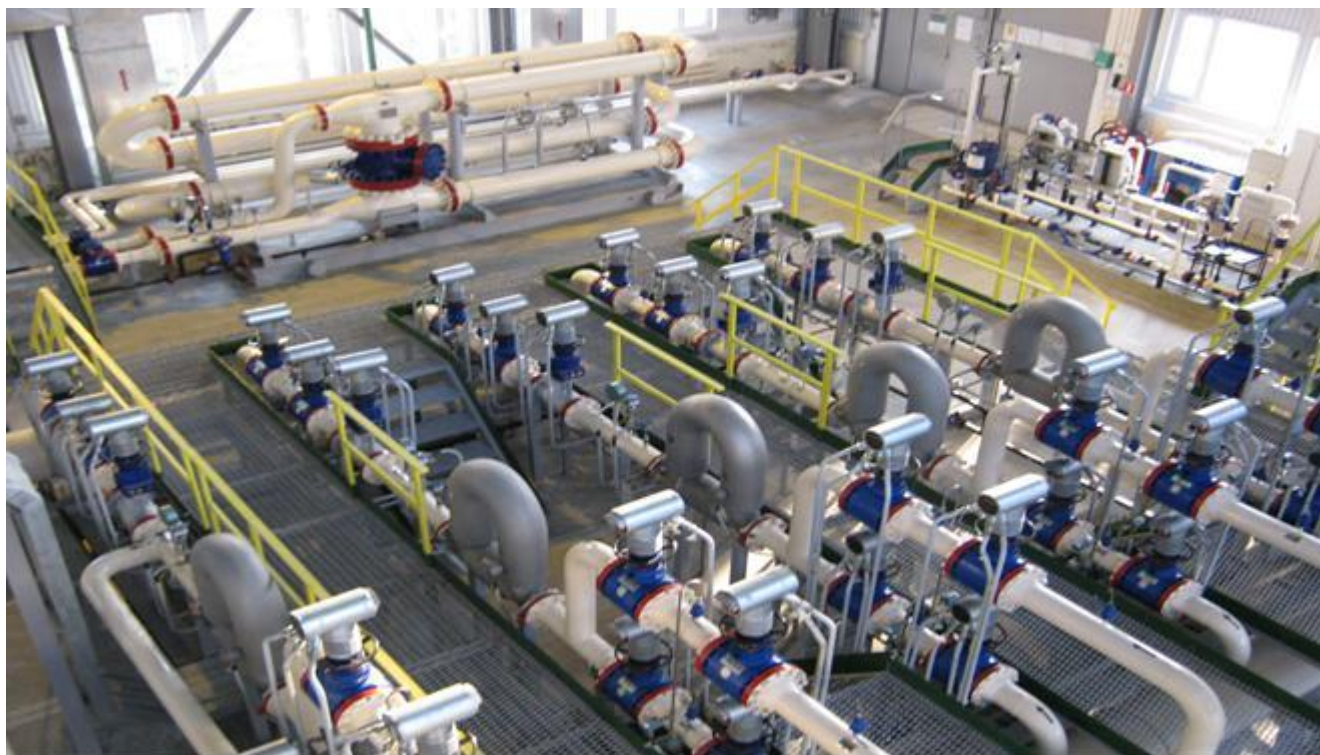
Рисунок 1 – Общий вид СИКН
