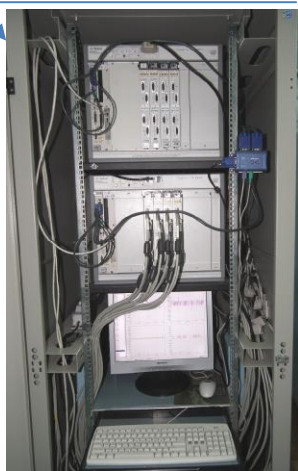
Рисунок 1 - Шкаф монтажный 19" ИВК ИС БМП
