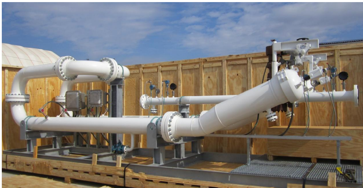
Рисунок 1 – Общий вид установок трубопоршневых двунаправленных ТПУ ЭМИС
