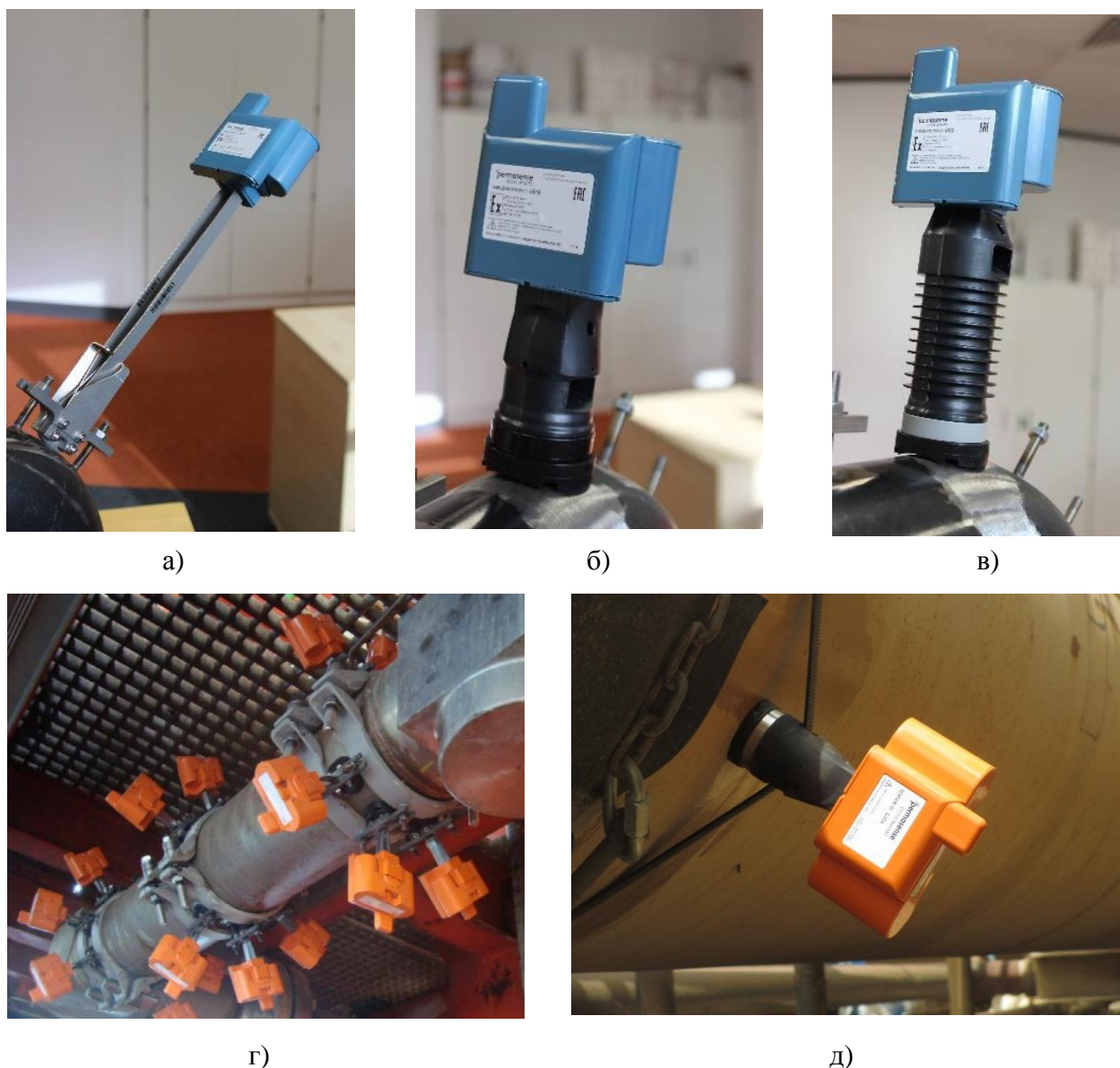
Рисунок 1 –Общий вид системы мониторинга коррозии и эрозии Permasense WirelessHART а) Датчик WT210; б) Датчик ET210; в) Датчик ET310; г) Общий вид крепления датчиков WT210 на трубопроводе; д) Общий вид крепления датчика ET210 на трубопроводе
