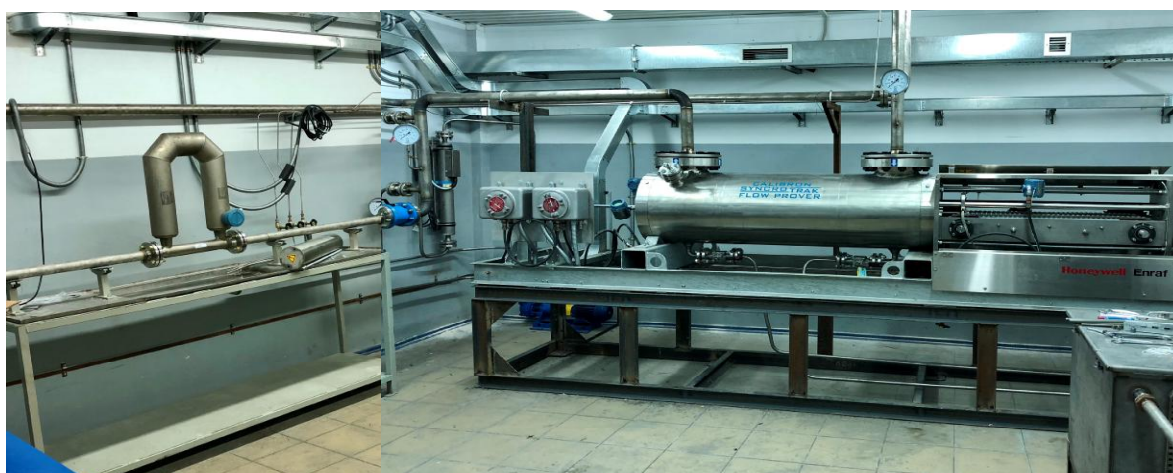
Рисунок 1 – Общий вид установки
